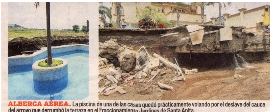
Daños causados a inmuebles por inundaciones en el territorio de Tlajomulco de Zúñiga Fotografía de fecha 25 de Junio del 2009 FUENTE: Periódico MURAL 26/Junio/2009
