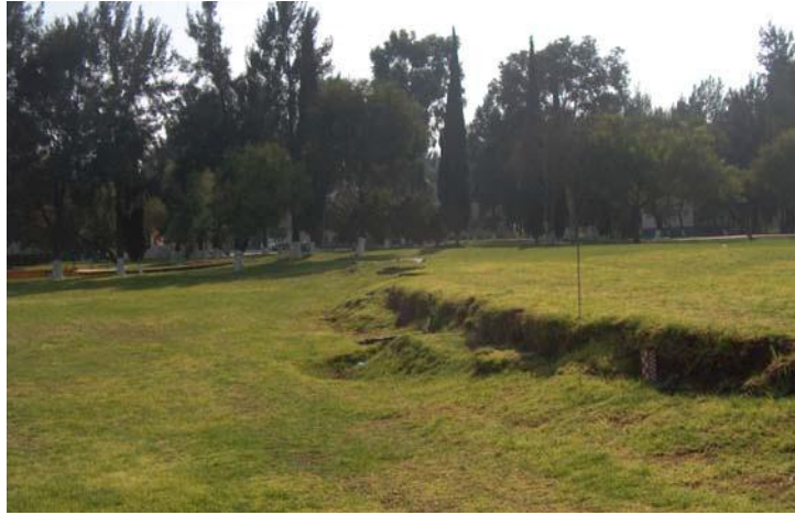
Fig 7 Agrietamiento con fuerte escalón en la zona lacustre (Tlahuac)
