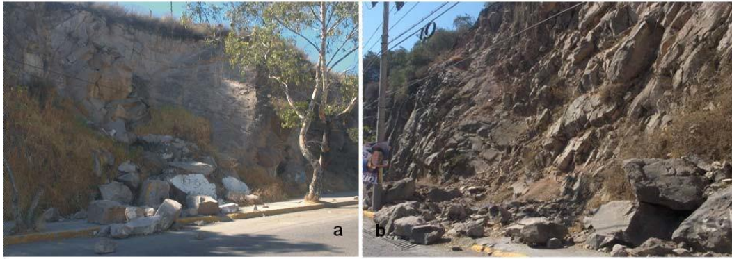
Fig 14 Desprendimientos de bloques (Jiménez, 2007)
