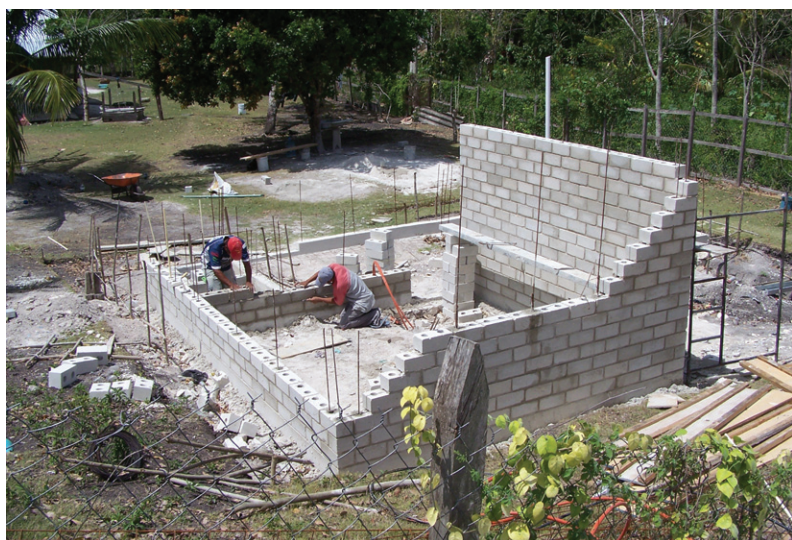
Producción social de vivienda ecológica en regiones de marginación Calakmul, estado de Campeche.
