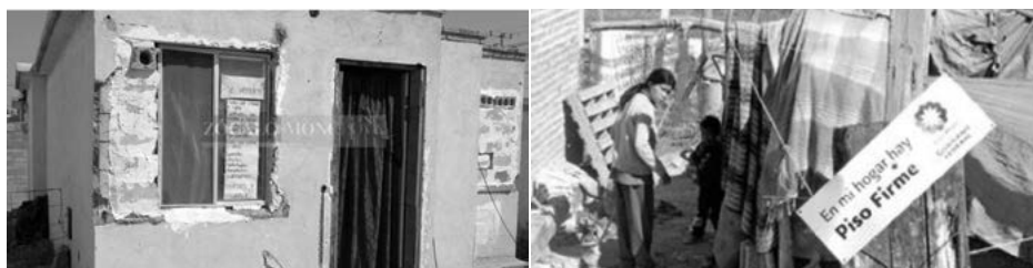
Foto 1. Las imágenes que muestran viviendas abandonadas y en deterioro y el uso político electoral del Programa Piso Firme
